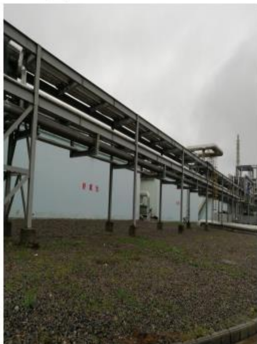
西厂区动力车间污水处理装置
