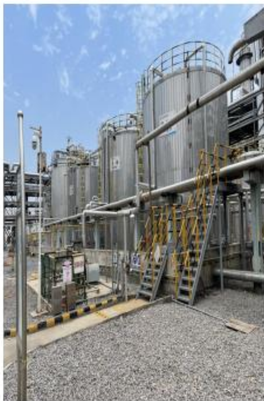
西厂区己内酰胺 2 车间中间罐区
