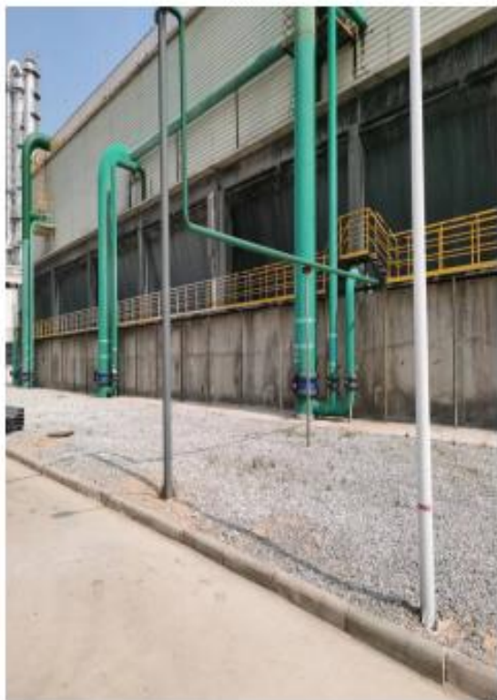
东厂区循环水池
