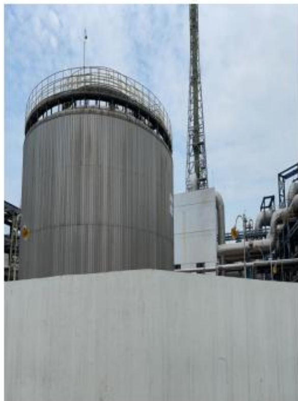
西厂区硫销车间硫酸工段液硫罐
