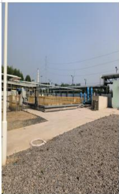
东厂区事故池
