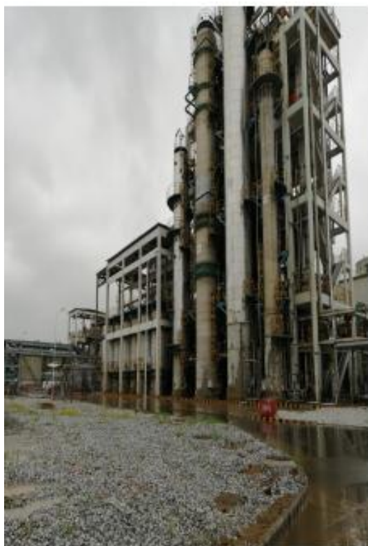
西厂区双氧水 1 车间
