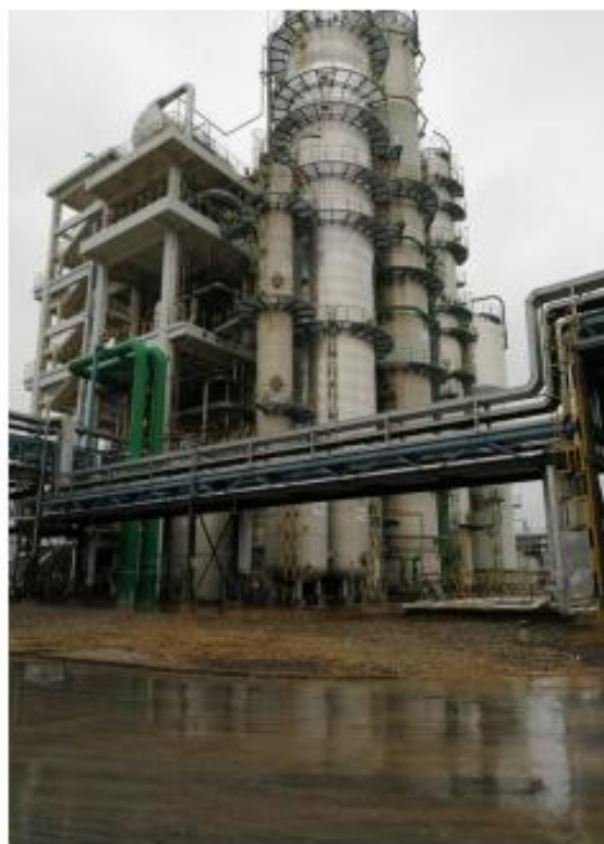
西厂区双氧水 2 车间
