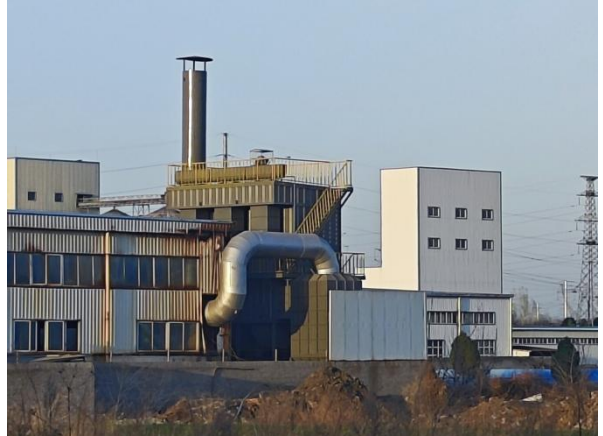
熔炼系统袋式除尘器、排气筒
