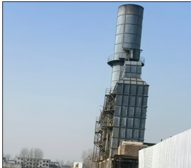
窑炉烟气处理装置
