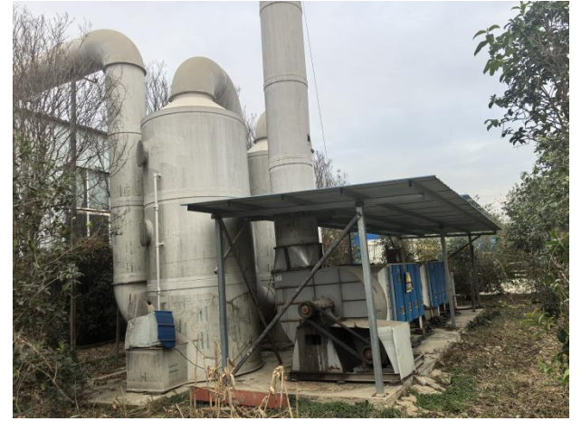
废气治理设施
