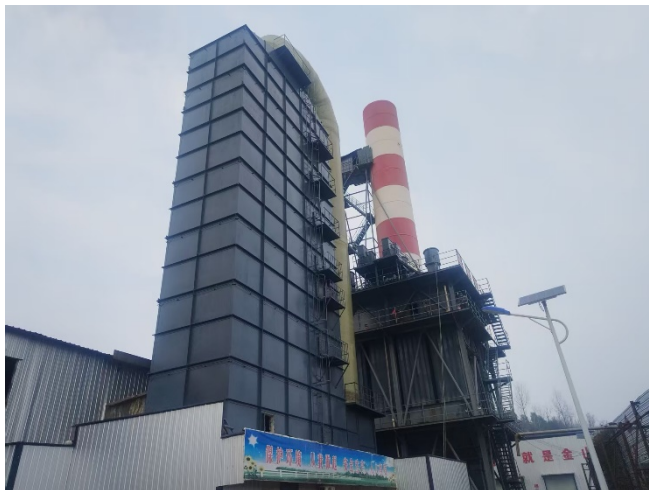
窑炉烟气处理装置及排气筒
