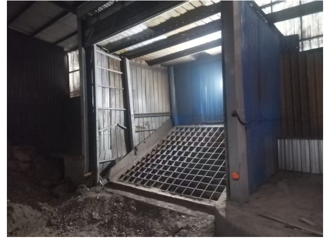
三面封闭喂料口
