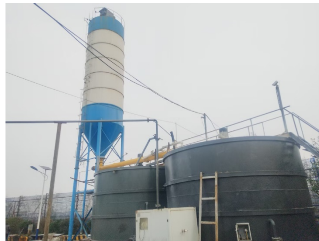
脱硫剂石灰仓及配浆罐
