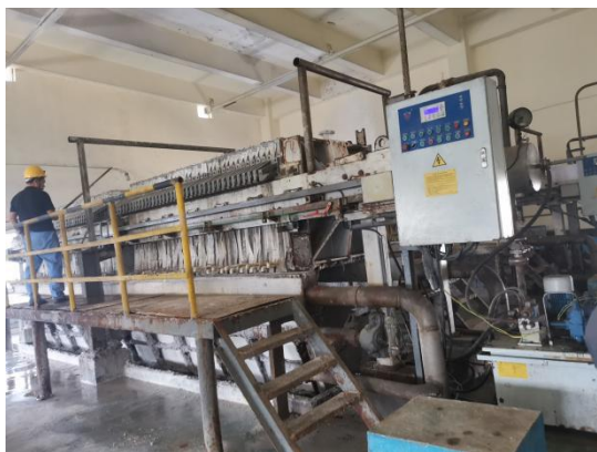
盐泥压滤机（盐泥产生点）
